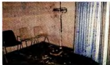
L'INFIRMERIA ALLAGATA Nell'impianto ormai fatiscente, l'infirmeria è allagata con l'intonaco rovinato finito a terra
