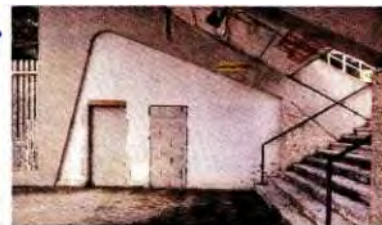
IL PALCO SENZA MANUTENZIONE Anche l'accesso al palco del Coni risulta senza manutenzione tra umidità e porte murate
